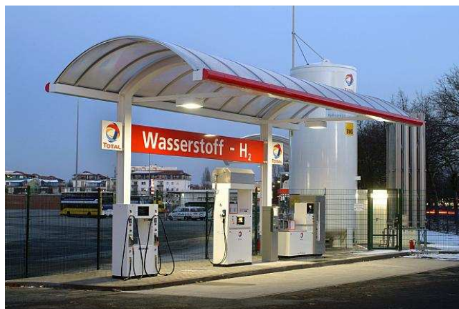
350 és 700 bar-os hidrogén tankolására képes töltőállomás Berlinben. Kép forrása: Total
