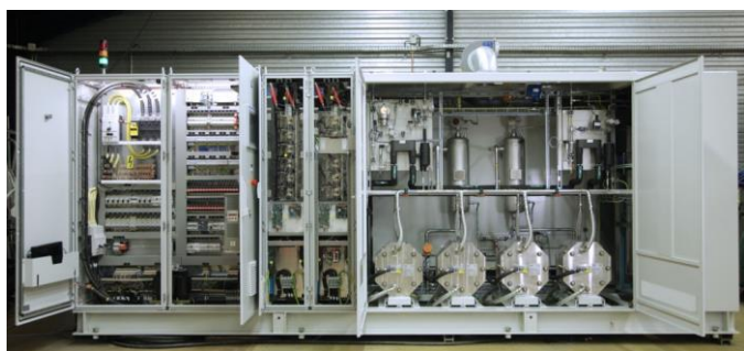
Konténeres felépítményű elektrolizáló. Kép: Areva H2Gen.
